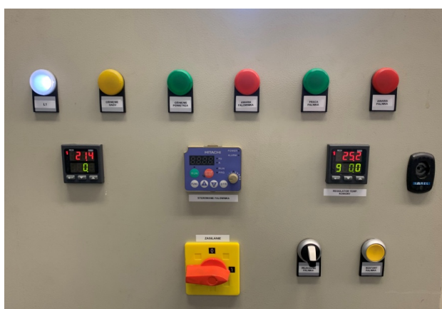
Rys. 21 Panel sterujący komorą reakcyjną.
